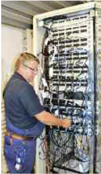
Am Telefonschrank muss innerhalb der Hausanlage auch mal umgestöpselt werden
